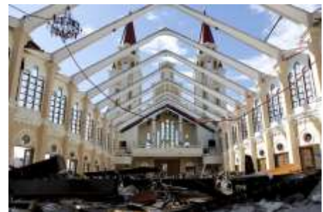
台風の被害で屋根が無くなった教会
