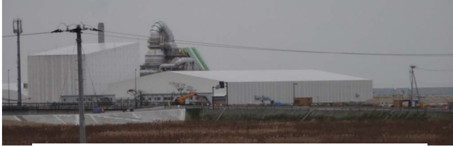
放射性廃棄物の減容化のための仮設焼却施設（浪江町）
